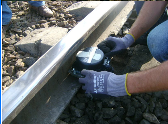
Установка сенсорного датчика
