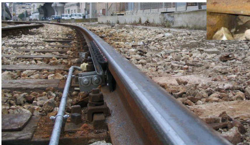
Вид смонтированной шины
