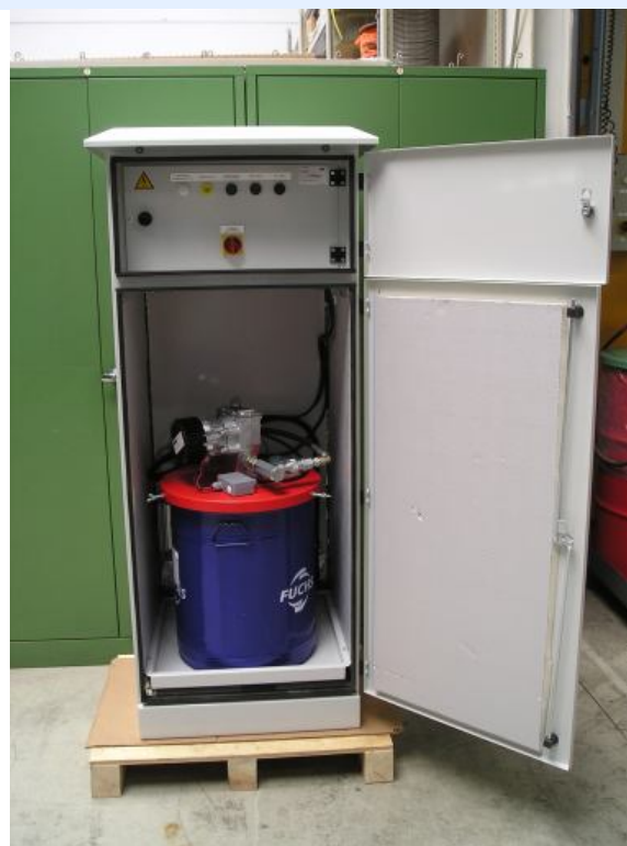
Насосная станция в шкафу
