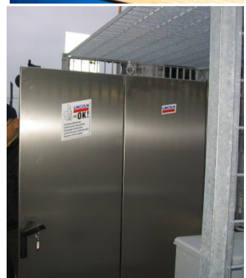
Шкаф управления общий вид
